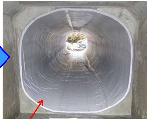
老朽化した函体の修繕
