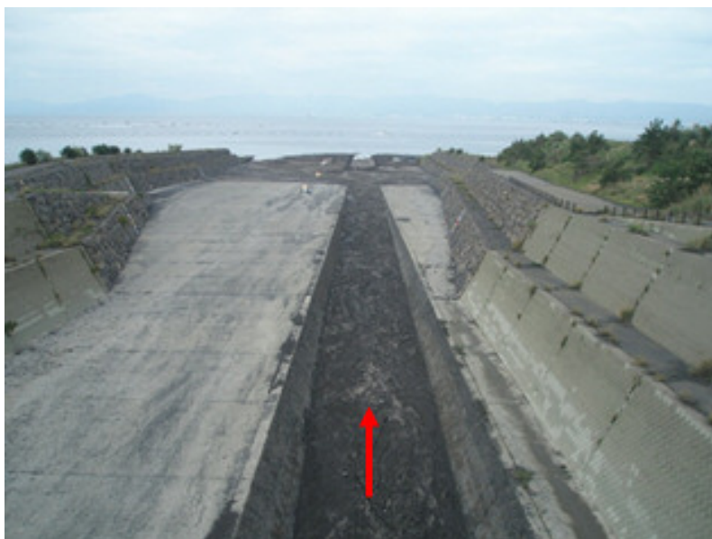
※河口から0k400付近まで土砂堆積が見られる。
