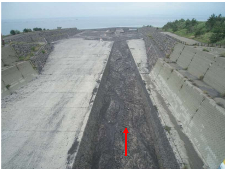
※河口から0k450付近まで土砂堆積が見られる。
