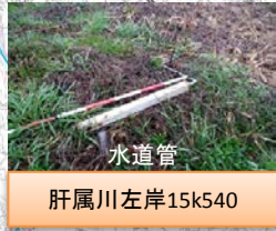
水道管 肝属川左岸15k540
