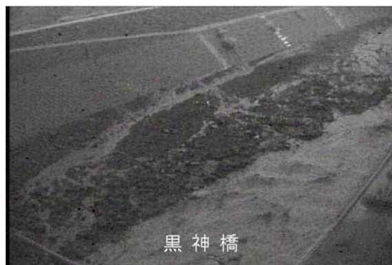
黒神橋 黒神川 土石流の様子(7月19日)
