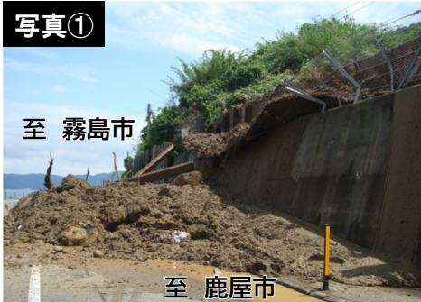
▲崩土のあった国道220号 (垂水市牛根境・H24.6)
