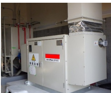
非常用発電機
