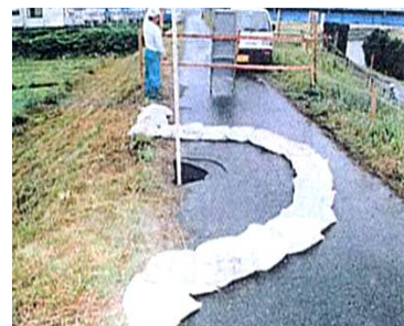
吸い出しによる堤体の空洞化 (H10.11 : 串良川左岸)
