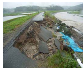
浸食による堤防の一部崩壊 (H16.8.30 : 始良川右岸)
