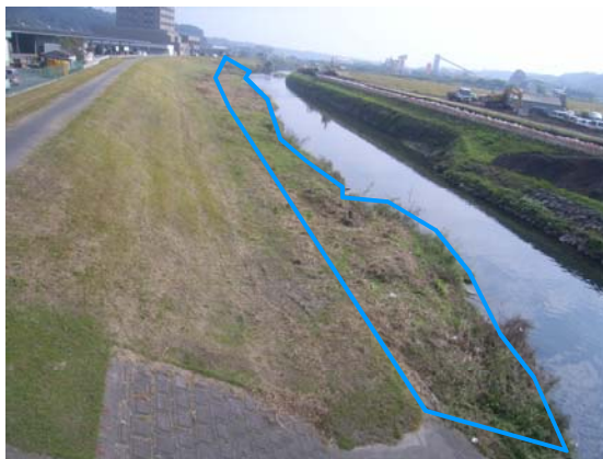
堆積土砂の状況
