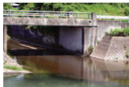
排水路からの汚水流入（肝属川上流）
