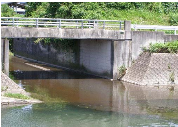
写真 2.2.24 排水路からの汚水流入 （肝属川上流）
