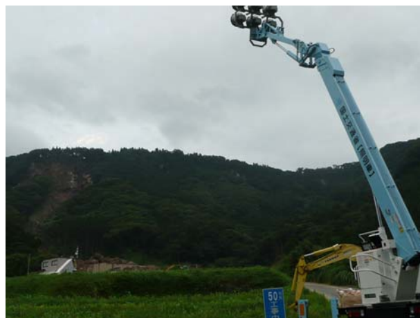
写真 4.3.18 夜間監視用の照明車
