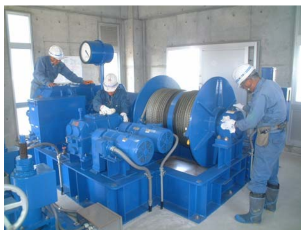
写真 4.3.5 水門（巻上機）の保守点検
