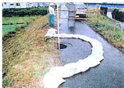
■堤体の空洞化 （支川串良川：平成 10 年 11 月）
