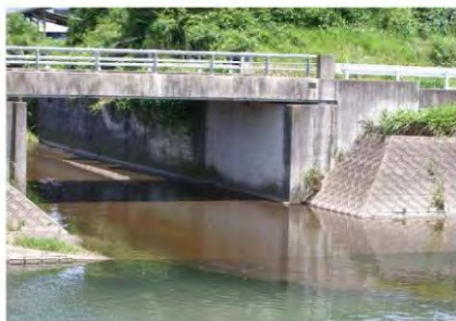
写真 2.2.24 排水路からの汚水流入（肝属川上流）
