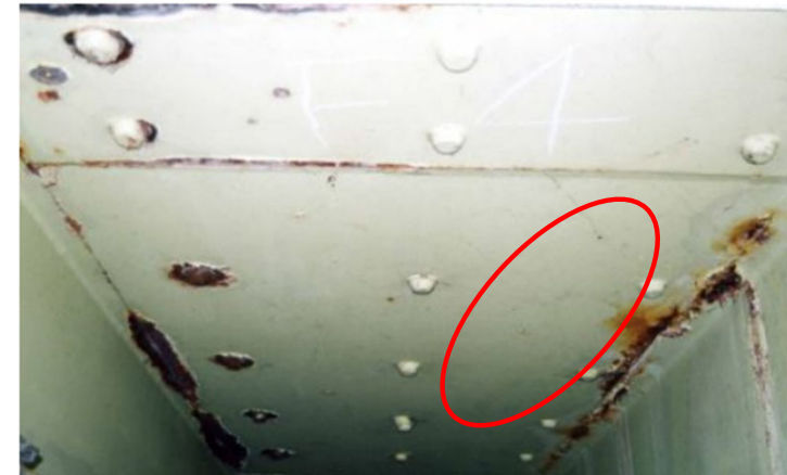
写真一鋼板のうき状況例 （参照：国総研資料第 748 号）
