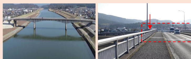
②天大橋（鹿児島県 薩摩川内市）：橋のつなぎ目の沈下等
