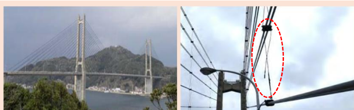
①呼子大橋（佐賀県 唐津市）：制振ワイヤーの損傷等
