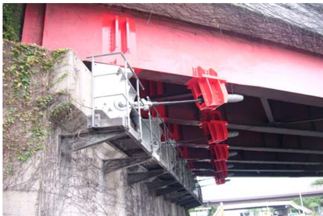
検査路と落橋防止システムの干渉事例
