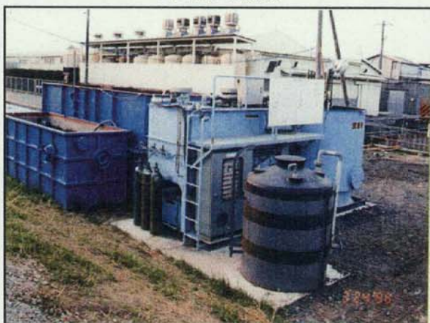
汚水処理設備
