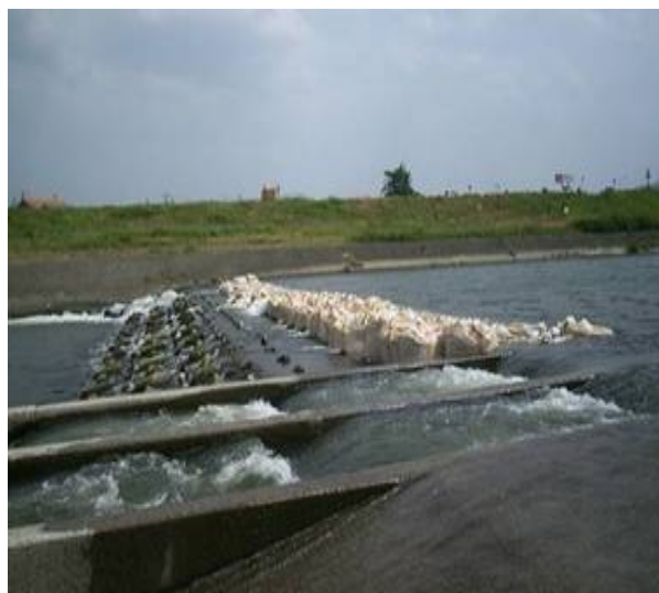
土囊取水 平成 17 年 6 月（大分市羽屋取水口）
