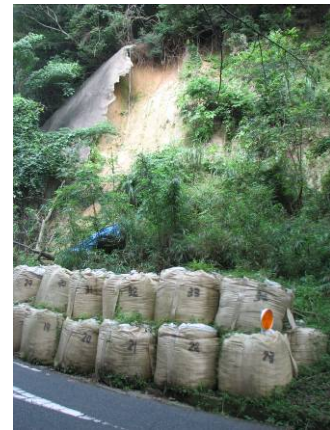
崩土の状況(H22年8月)
