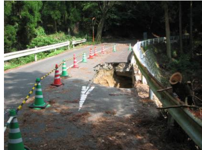
路面陥没の状況(H22年8月)
