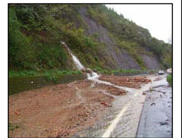
▲国道10号の被災状況
