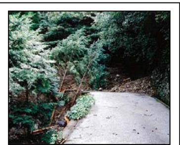
▲国道388号の被災状況
