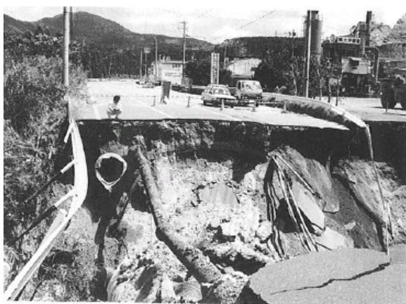
▲河川の氾濫で大きく陥没した県道
