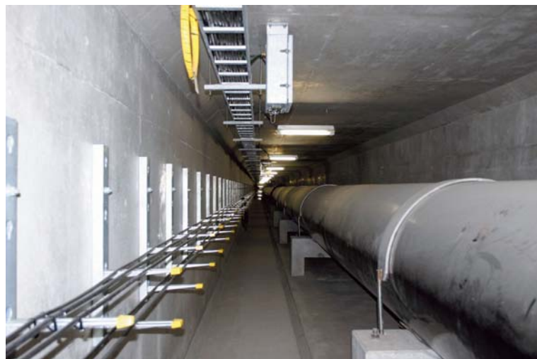
▲共同溝内に収容された上水道管
