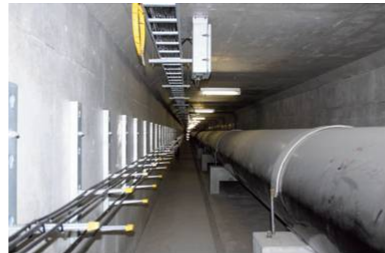
▲共同溝内に收容された上水道管
