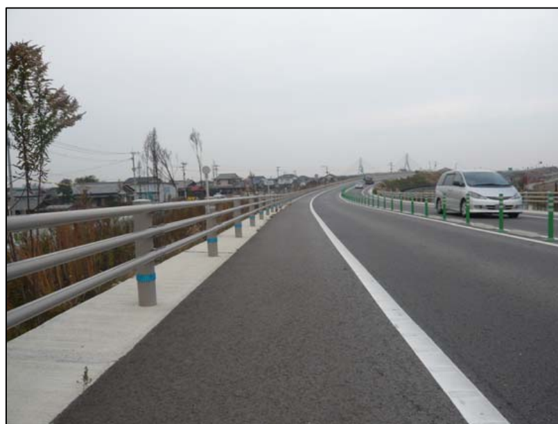
▲ 周辺景観との調和を考慮した防護柵（グレーベージュ）
