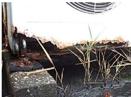
設備機器の破損
