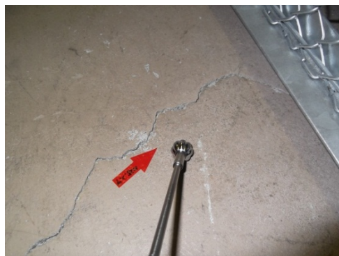
書庫床構造体のひび割れ
