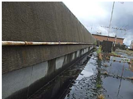
屋上防水の劣化
