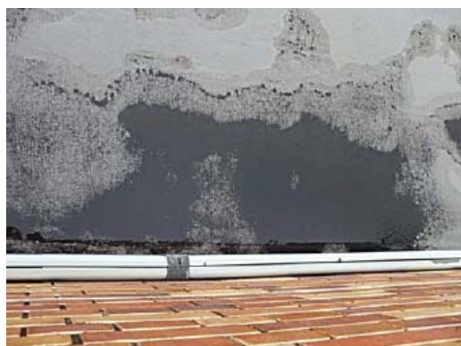
玄関上部防水の劣化
