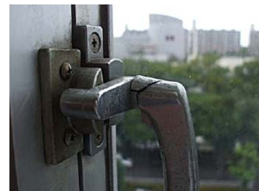
窓の施錠金具の破損
