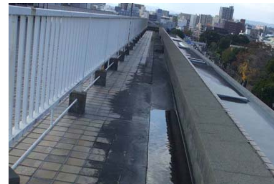
屋上防水の劣化
