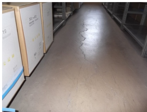
倉庫床構造体のひび割れ
