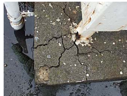
設備機器基礎のひび割れ
