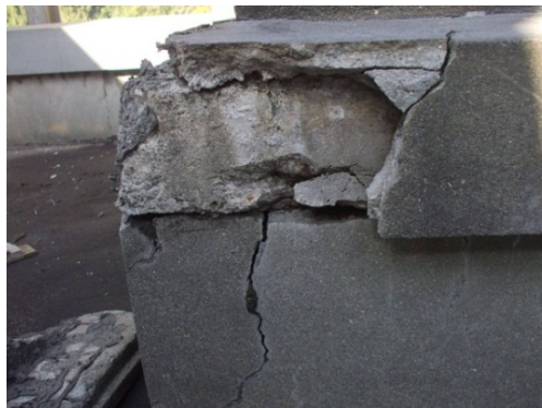
屋上防水上部のひび割れ
