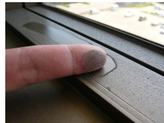
窓の隙間からの火山灰の進入
