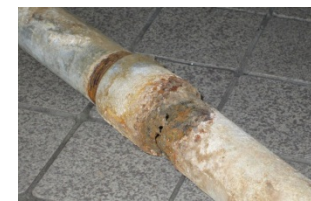
排水管の劣化
