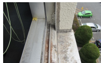
外部建具の劣化
