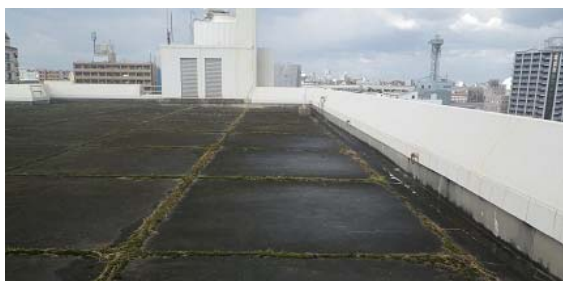
天井からの雨漏り
