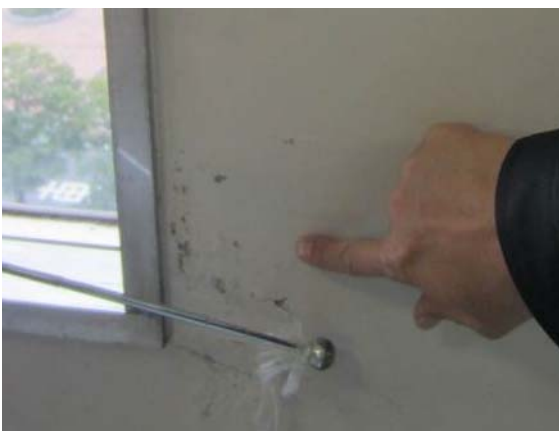
外壁から室内への漏水
