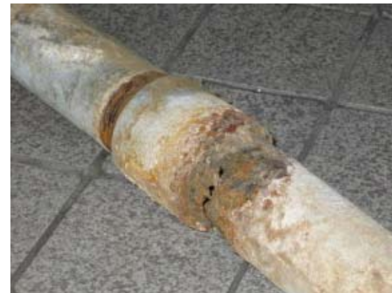
排水管の劣化
