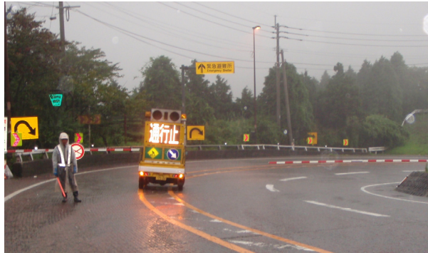
▲ 事前通行規制の状況
