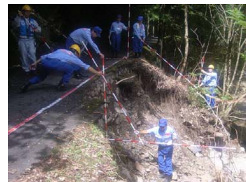
被災状況調査 道路班(田辺市龍神町)
