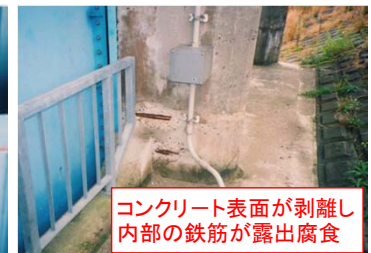
ひび割れが見られる門柱部
