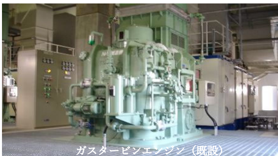
ガスタービンエンジン (既設)
