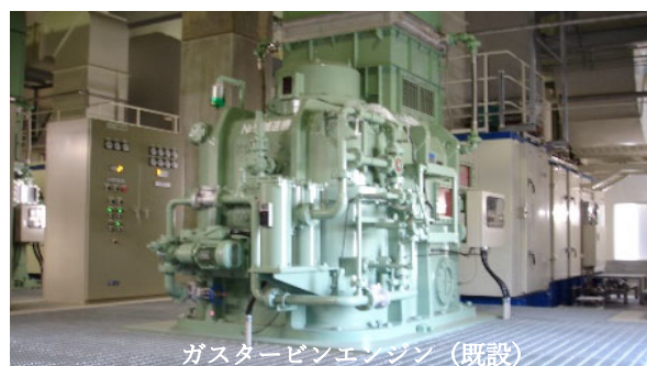
ガスタービンエンジン (既設)
