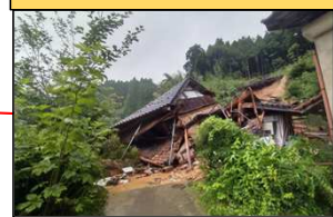
土砂災害 (富士町:市道上浦線)
