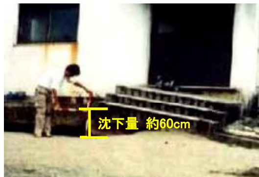
写真 2.2.7 白石町での地盤沈下状況
