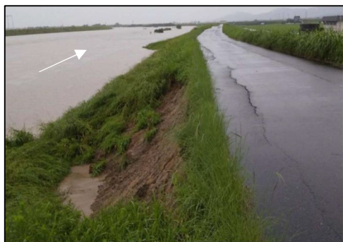
写真 1.2.1 堤防の法崩れの様子
