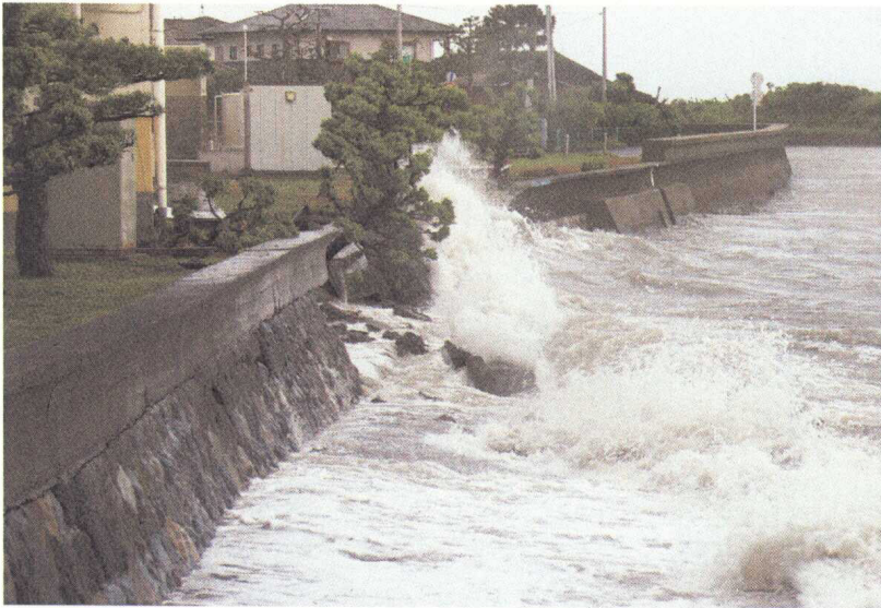
①【長崎県島原港大手浜地区】 波浪によって、護岸【石積+パラペット上部】が決壊した。
