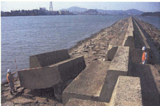
②【福岡県苅田港南港地区】 波浪・高潮によって、防波堤上部工が転倒した。
