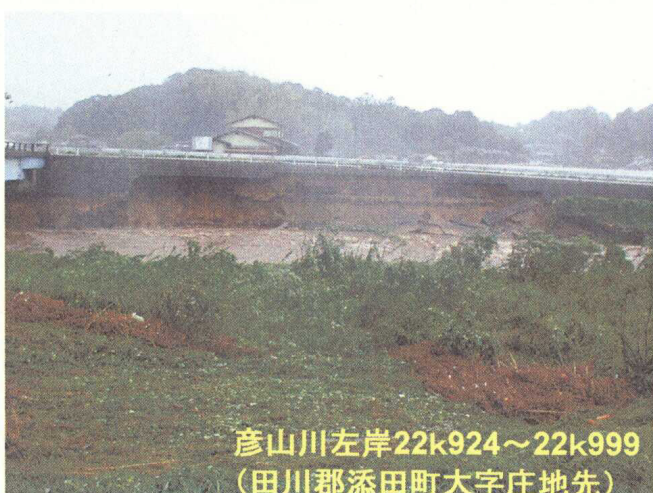
遠賀川(彦山川)の堤防護岸被災(台風18号)
