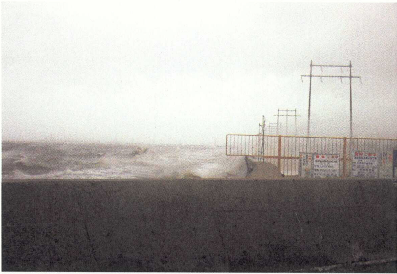
①【福岡県大牟田港健老開地区】 波浪によって、海岸堤防の捨石が破損した。
