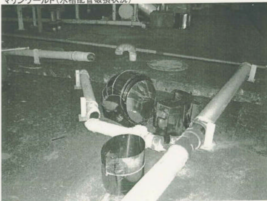
マリンワールド(水槽配管破損状況)
