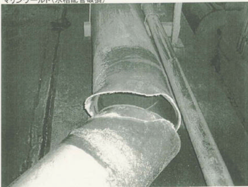
マリンワールド(水槽配管破損)
