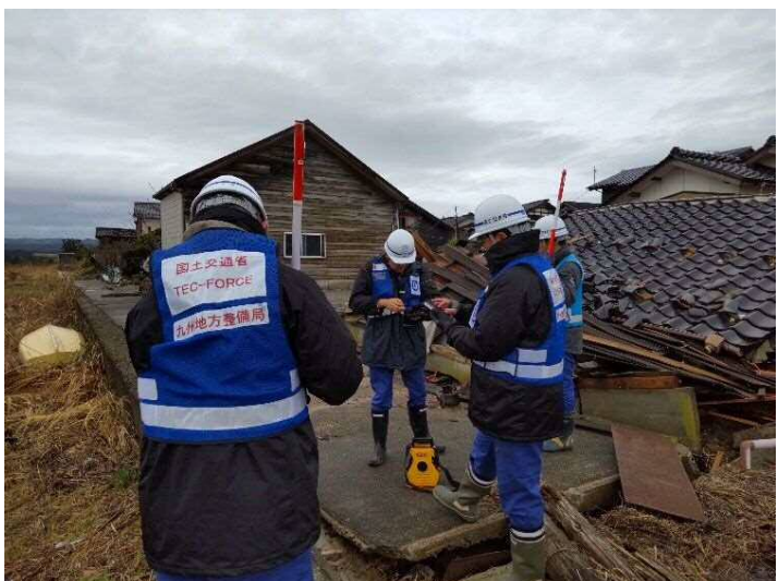
△海岸護岸被災状況調査（珠州市正院町）
