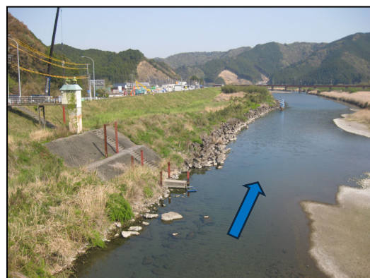
河岸付近の洗掘状況（小田地区）
