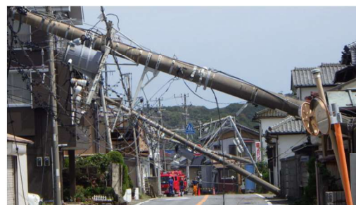
台風により倒壊した電柱
