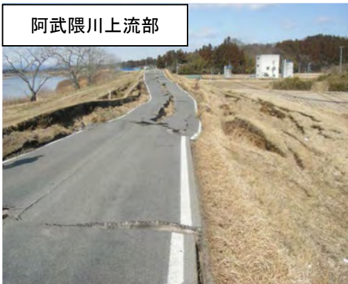
地震による堤防の被災状況
