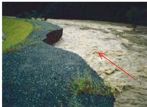
写真 2.1.1 堤防（川表側）侵食状況 (平成9年9月洪水 久留須川 ながさき 長崎地区)
