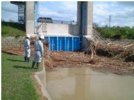
写真 4.3.7 平成 17 年 9 月洪水後の流木塵芥（女島水門）
