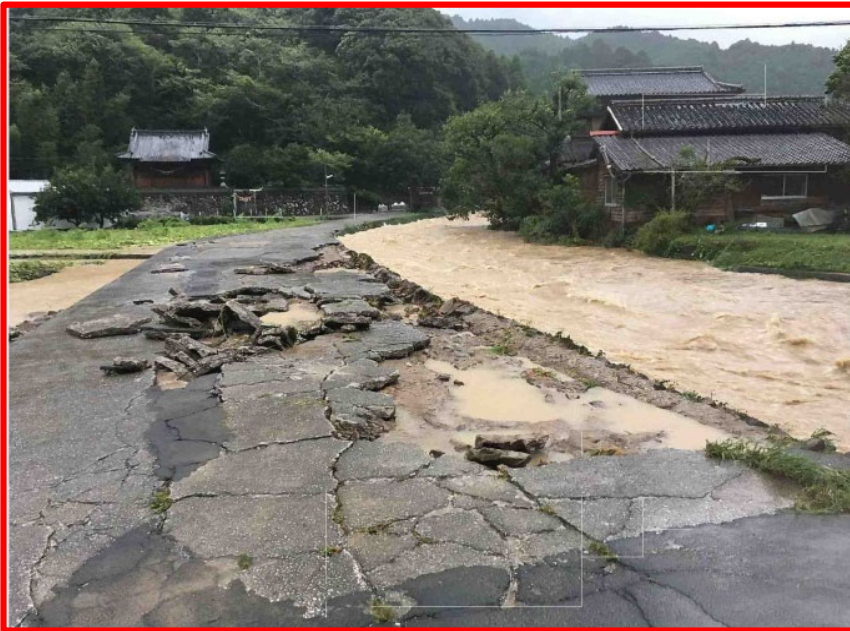
写真2.1.1 提内川の浸水状況 (平成29年9月)
