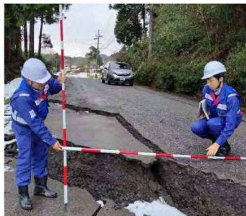
▲道路通行可能調査(輪島市)
