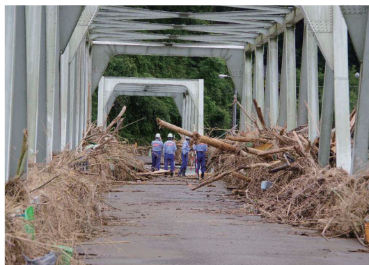
橋梁流出箇所調査(熊本県人吉市)
