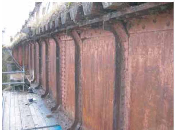
写真 - 11 支間部の主桁の劣化状況
