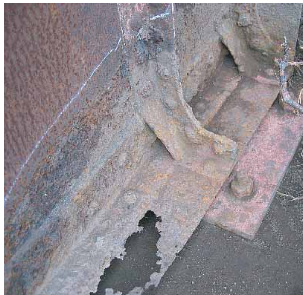
写真 - 10 中間支点付近の主桁下フランジの劣化状況
