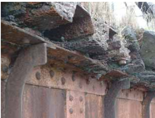
写真 - 9 主桁上フランジの腐食劣化状況
