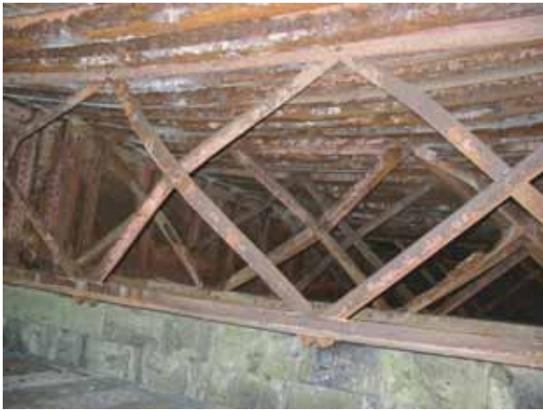
写真 - 8 床版下面の陥没状況
