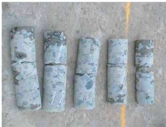
写真-6 コア抜きした床版コンクリート わが国に鉄筋コンクリート(RC)構造物が初めて
