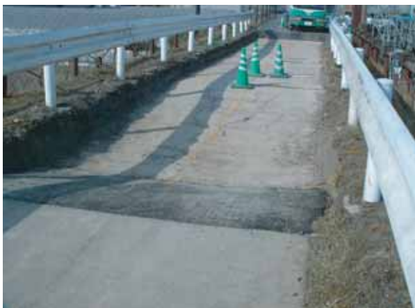
写真 - 7 床版上面の陥没状況
