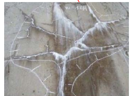
【P7橋脚部のひび割れ】
