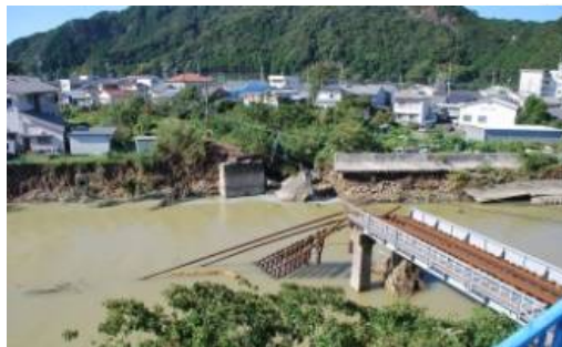
紀勢線 なち 那智川橋りょう流出
