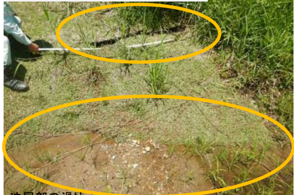
写真②(法面変状状況)
