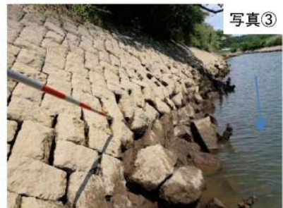
石積みのすべり
