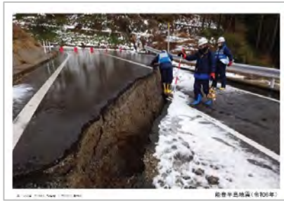
R6能登半島地震による被害状況⑦
