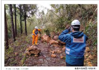
R6能登半島地震による被害状況⑨
