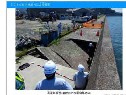
H26台風8号（薩摩川内市船間島地区（高潮））②
