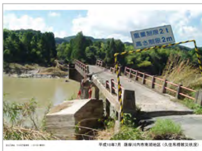
H18.7月豪雨 (薩摩川内市南瀬地区) (久住吊橋被災状況)
