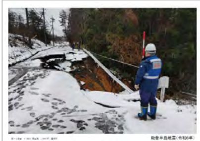
R6能登半島地震による被害状況⑩
