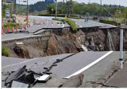
H28熊本地震による被害状況②
