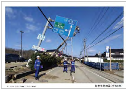
R6能登半島地震による被害状況①
