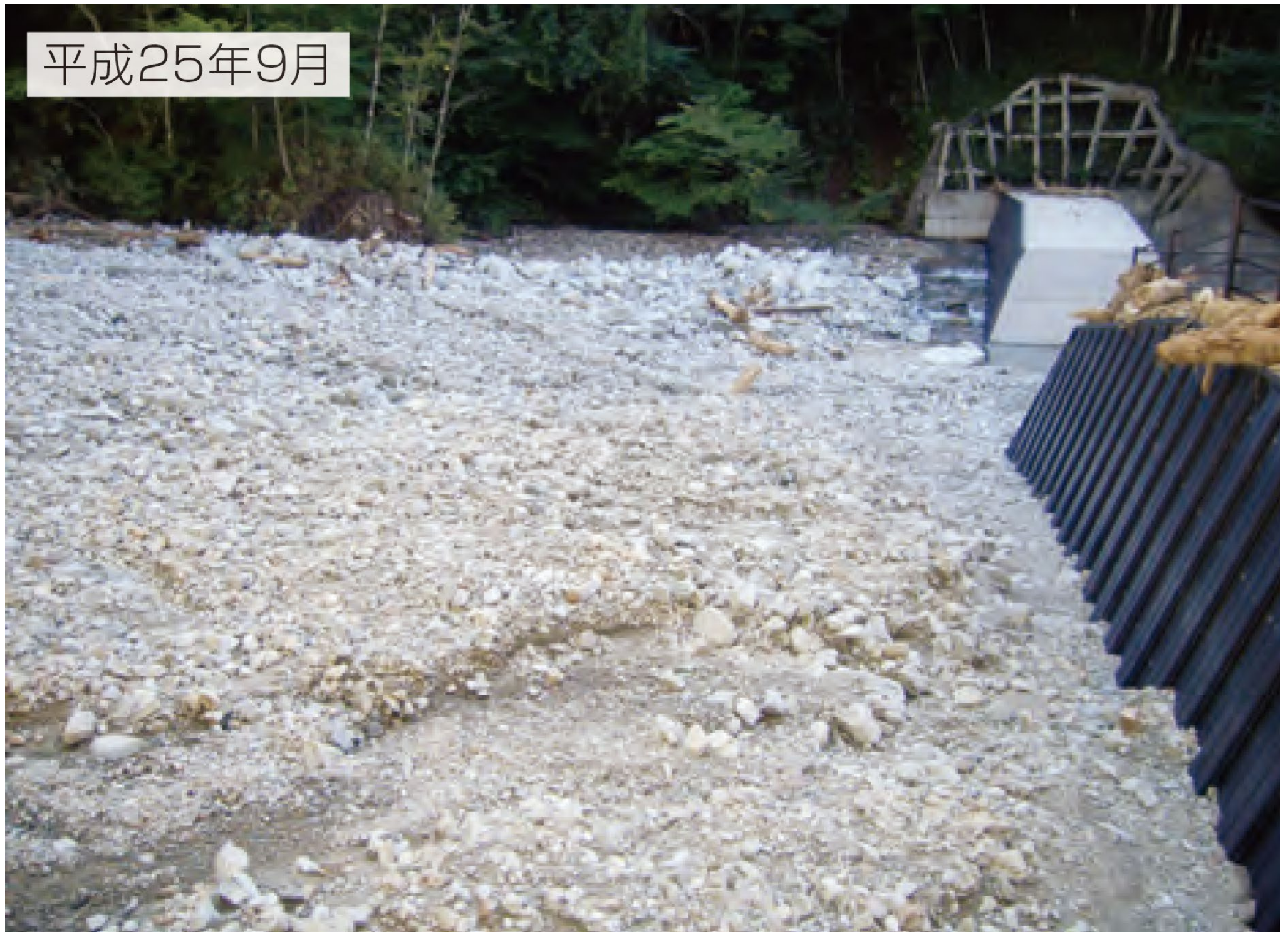
土石流発生後の砂防ダム(本谷第10砂防堰堤)
